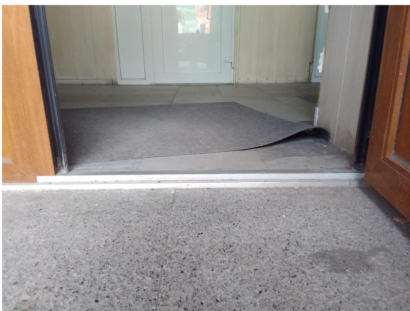
Фото 2.5 Порог входной двери
