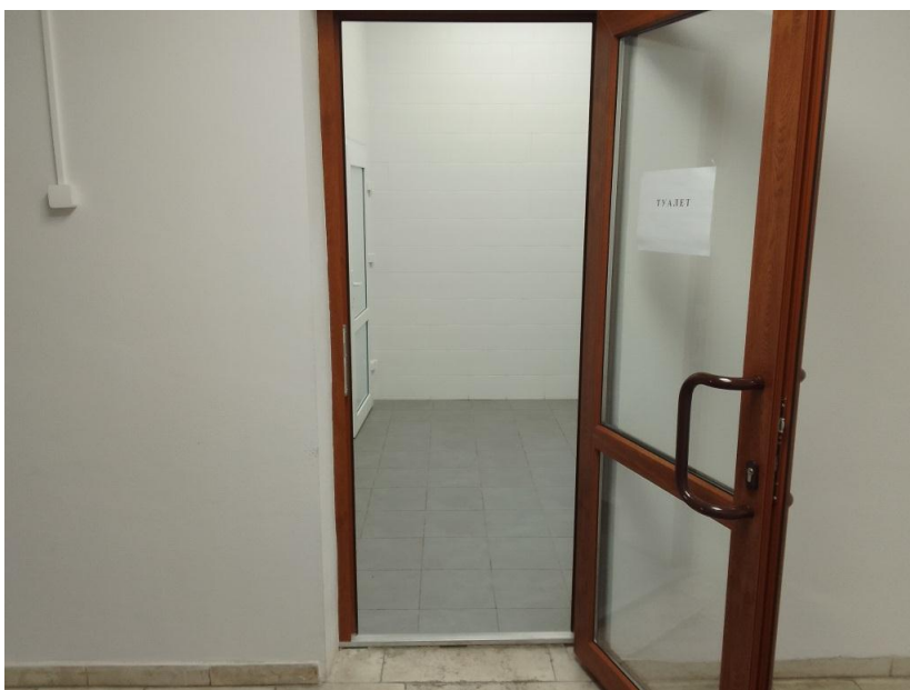
Фото 5.2 Проем двери в туалетную комнату, предполагающуюся к адаптации для инвалидов
