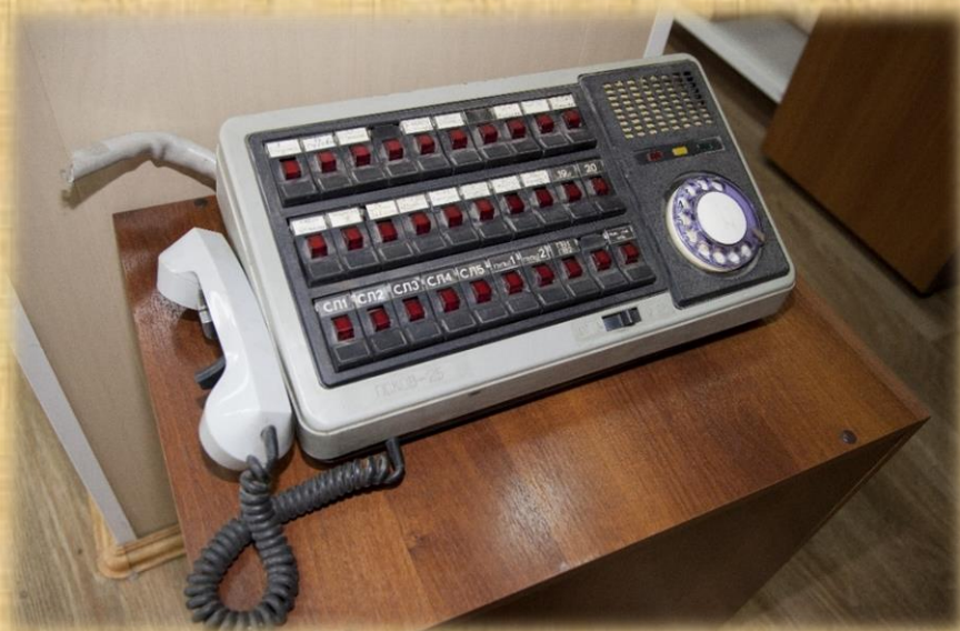
Автоматическая телефонная станция ПСКОВ-25
